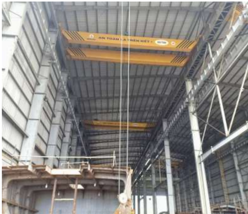
Hình 1.11 Cầu trục 20 tấn
