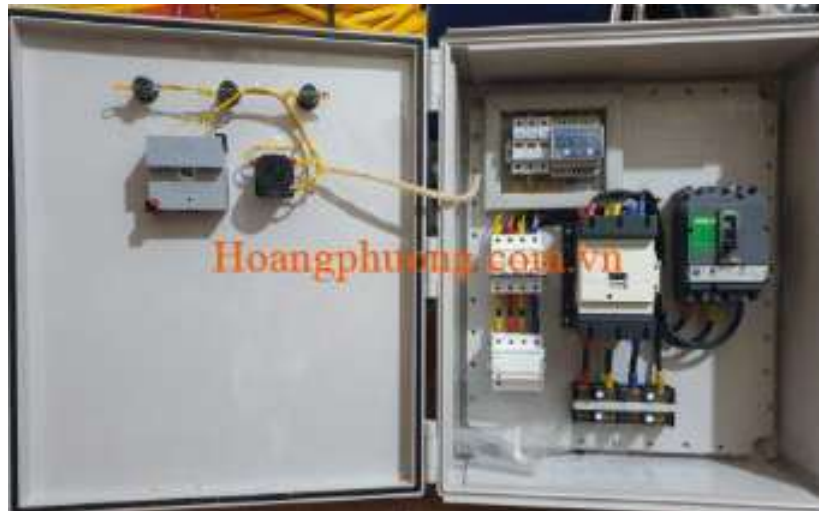
Hình 5.8: Tủ bảo vệ chống sét Schneider [45]
