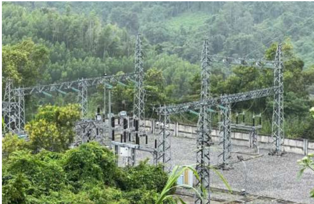
Hình 1.3 Trạm phân phối điện ngoài trời
