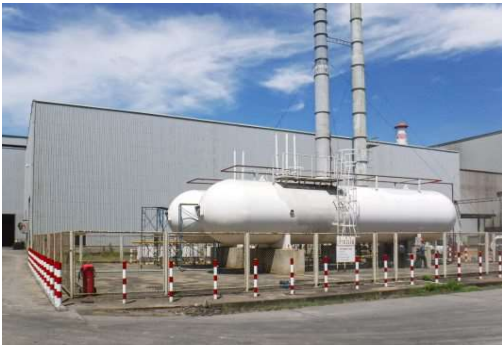
Hình 1.6. Hệ thống bồn chứa gas
