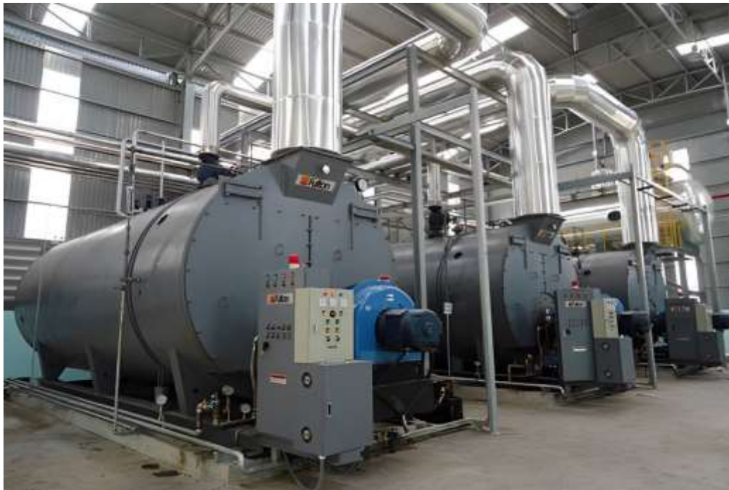
Hình 1.5. Lò hơi nhà máy nhiệt điện
