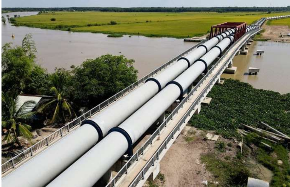
Hình 1.1. Đường ống dẫn nước thủy lợi ở Tây Ninh
