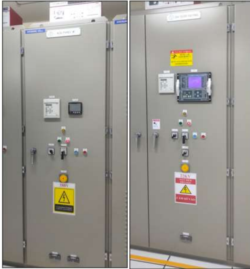
Hình 2-5: Tủ nguồn 22kV và tủ nguồn 380V
