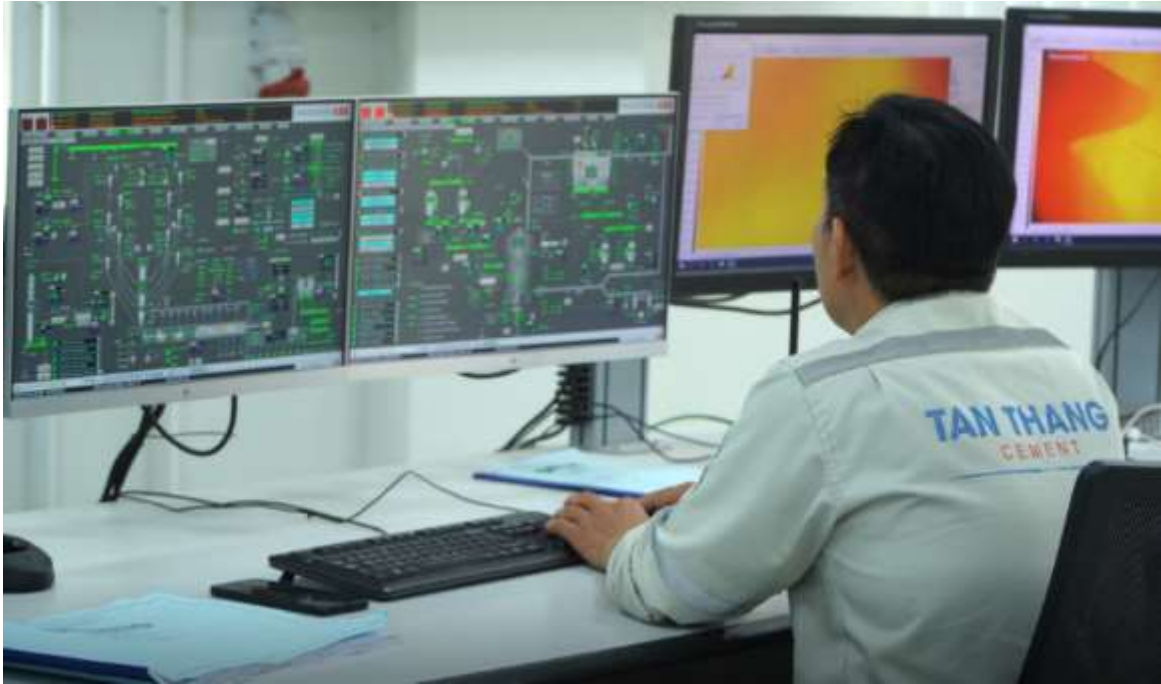
Hình 1-3: Phòng điều khiển trung tâm kiểm soát toàn bộ hoạt động của nhà máy xi-măng Tân Thắng
