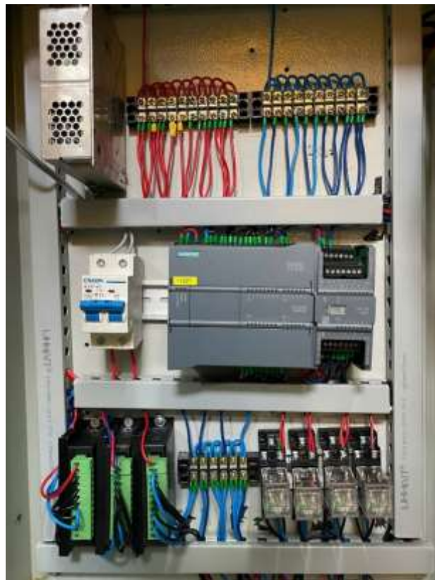
Hình 5.5 Bên trong tủ điện
