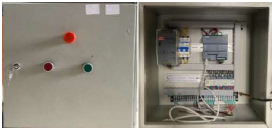
Hình 4.5 Tủ điện PLC
