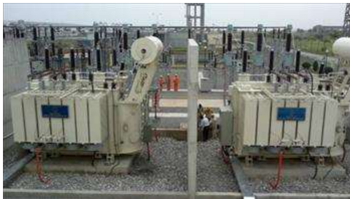
Hình 1.2. MBA T3, T4, Trạm biến áp 110kV KCN Thăng Long II
