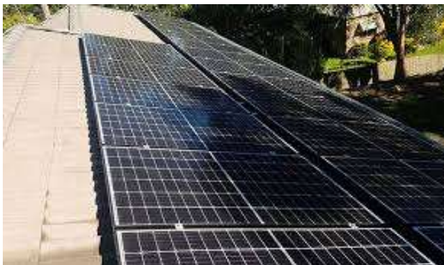
Hình 1.4. Các tấm pin bị bóng che bởi cây cối
