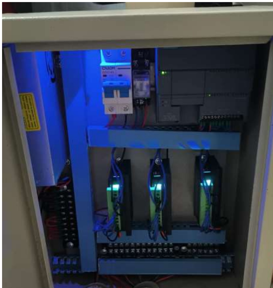
Hình 5.1 Tủ điện của hệ thống
