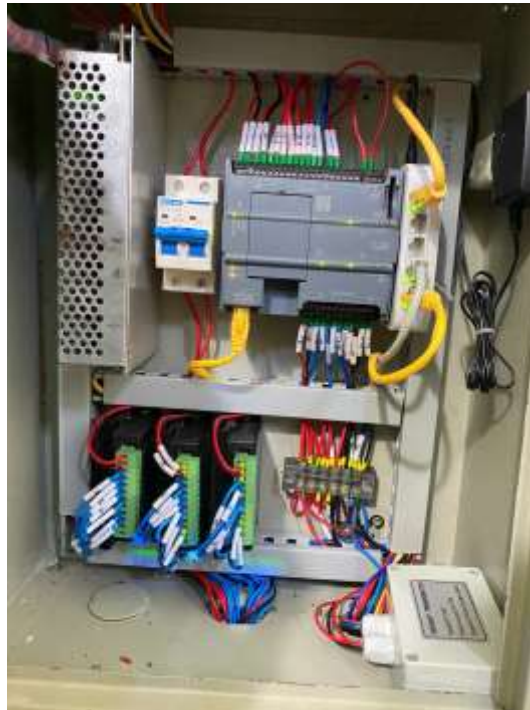
Hình 5-18. Bên trong tủ điện.
