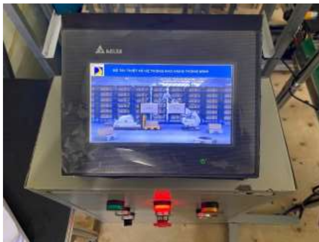
Hình 5-20. Mặt trên của tủ điện.
