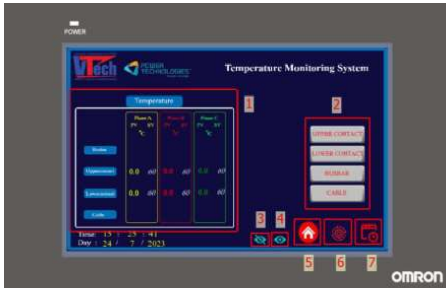
Hình 3.11 . giao diện màn hình HMI (Human-Machine Interface)
