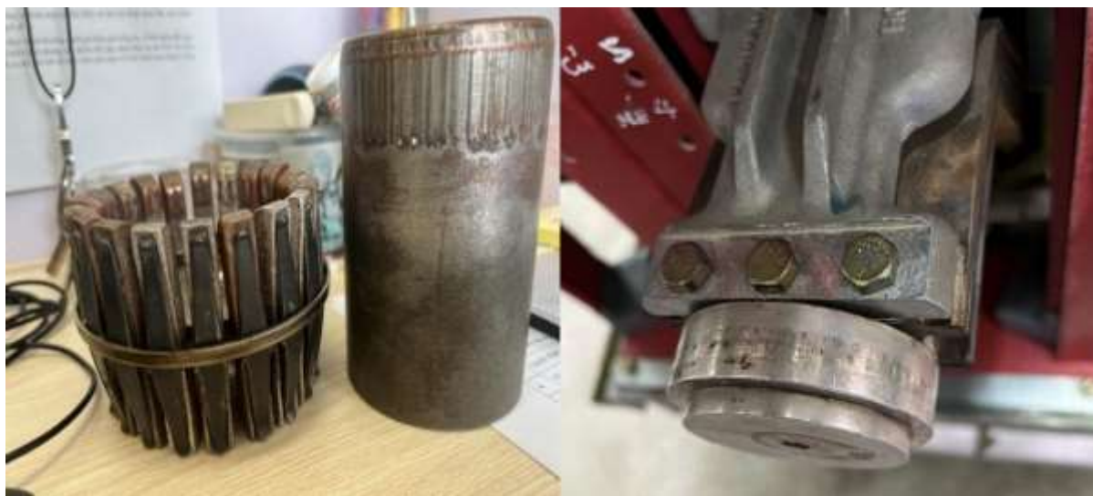
Hình 2.1 .Một số hình ảnh thực tế về tiếp điểm bị cháy rỗ
