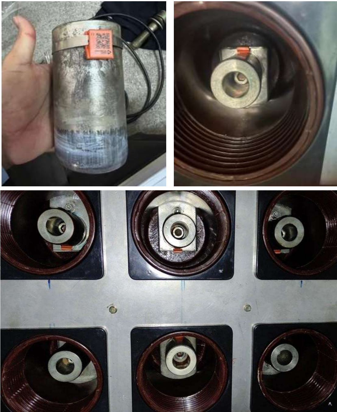
Hình 4.9. Cảm biến nhiệt không dây lắp tại tiếp điểm máy cắt 901
