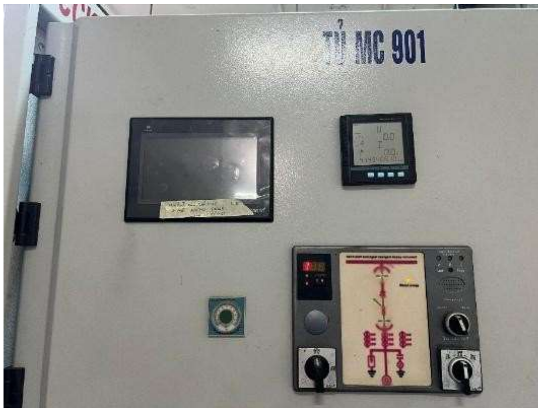
Hình 4.10. Màn hình HMI giám sát lắp tại tủ
