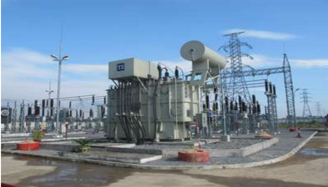
Hình 3.1 Trạm điện 100Kv Hoà Khánh 2
