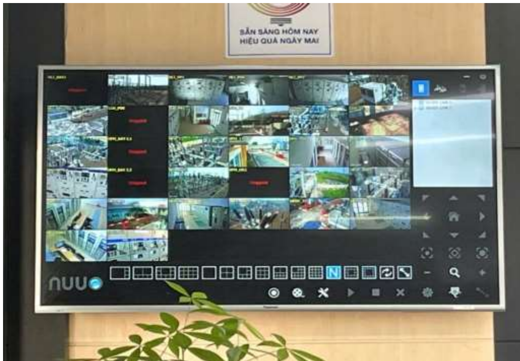
Hình 1.6 Giám sát trạm biến áp từ xa
