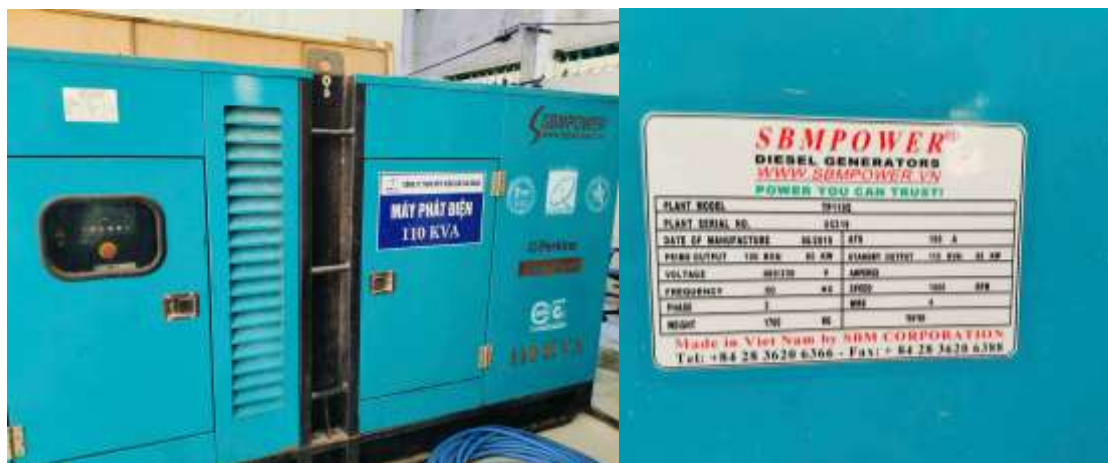
Hình 3.3. Máy phát Diesel 100kVA tại Công ty
