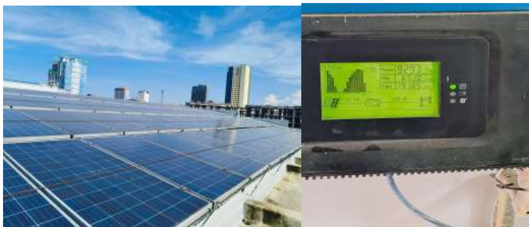
Hình 3.2. Hệ thống pin mặt trời tại mái và bộ inverter
