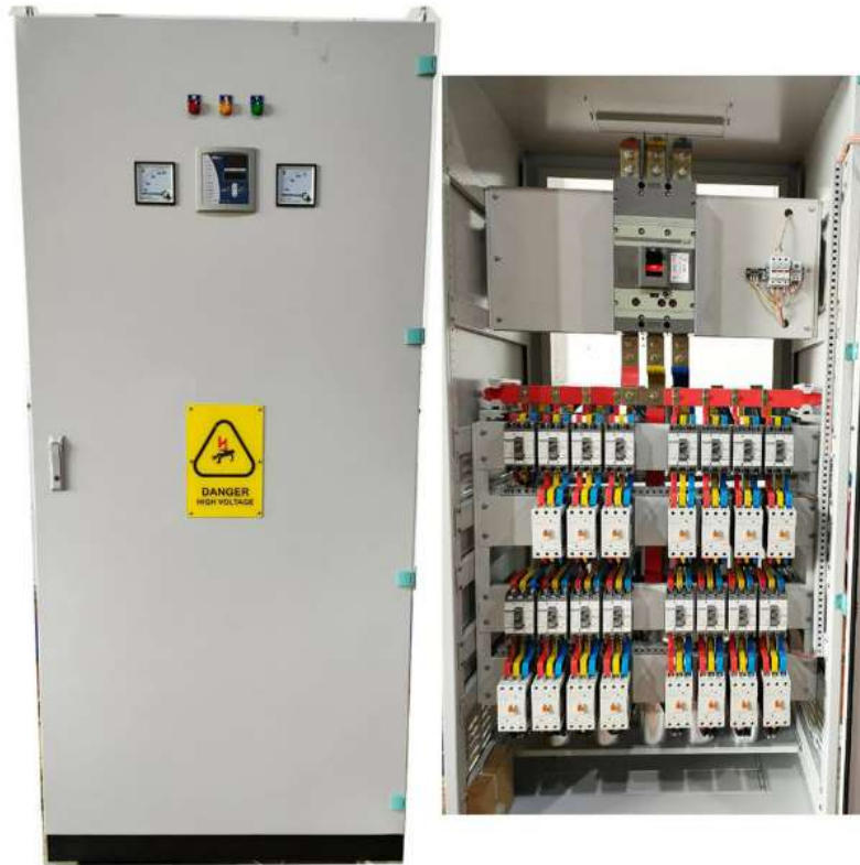
Hình ảnh tủ điện hạ thế
