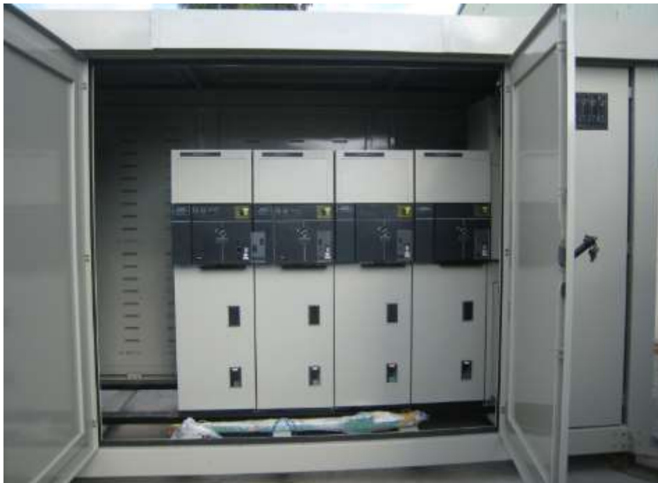
Hình ảnh tủ điện trung thế
