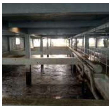
Hình 3.1. Bể SBR 1 (Hoạt động)
