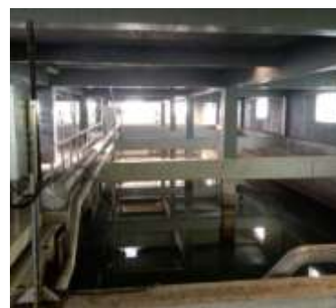
Hình 3.2. Bể SBR 2 (Không hoạt động)
