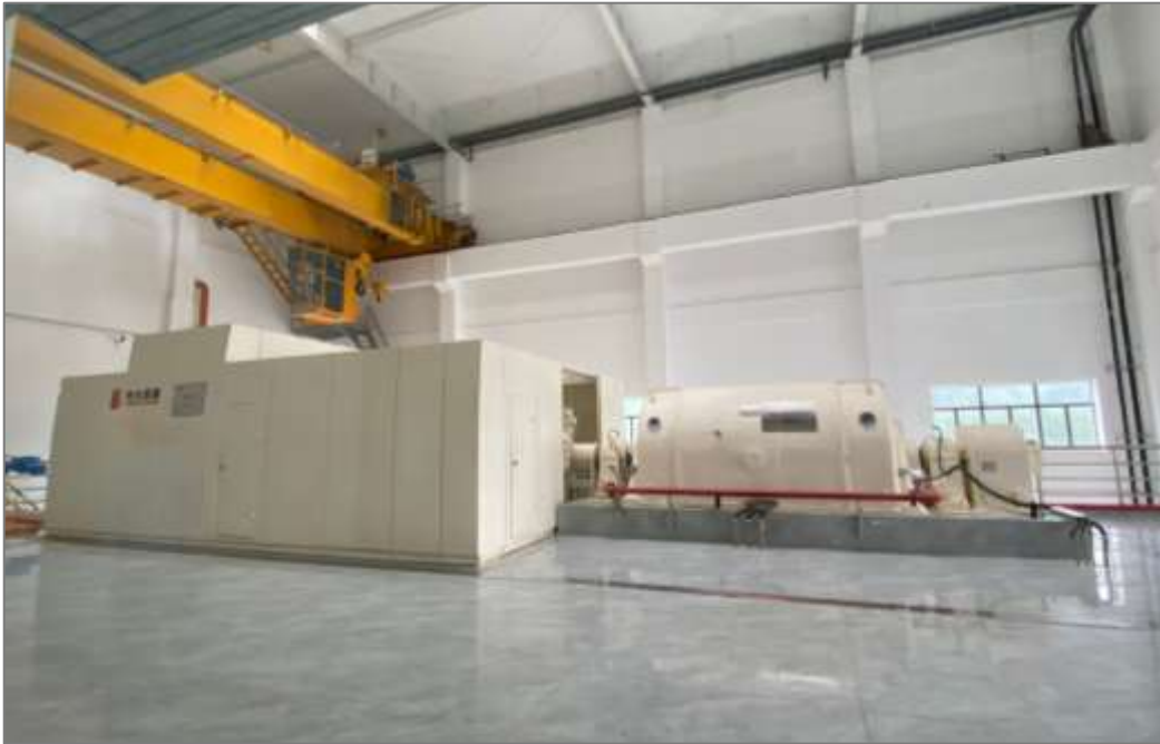
Hình 2. 4: Tổ máy điện tuabin hơi
