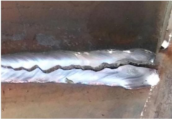
Hình 4.9: Mối hàn bị nứt
