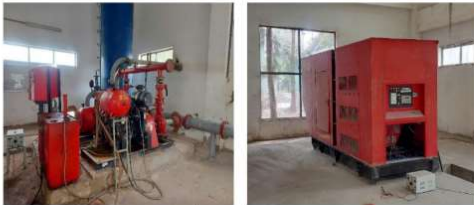
Hình 4. 2 Hệ thống bơm PCCC và máy phát điện
