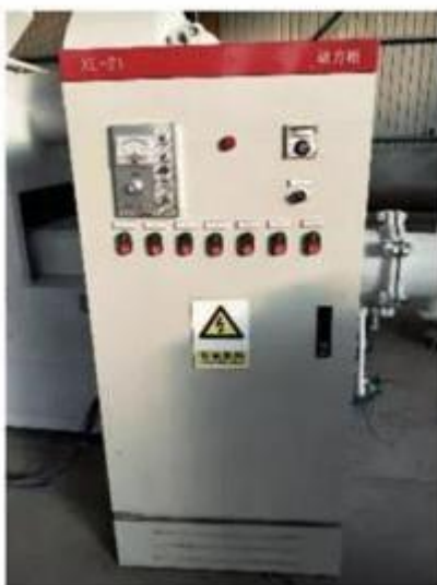
Hình 2.18:Tủ điều khiển
