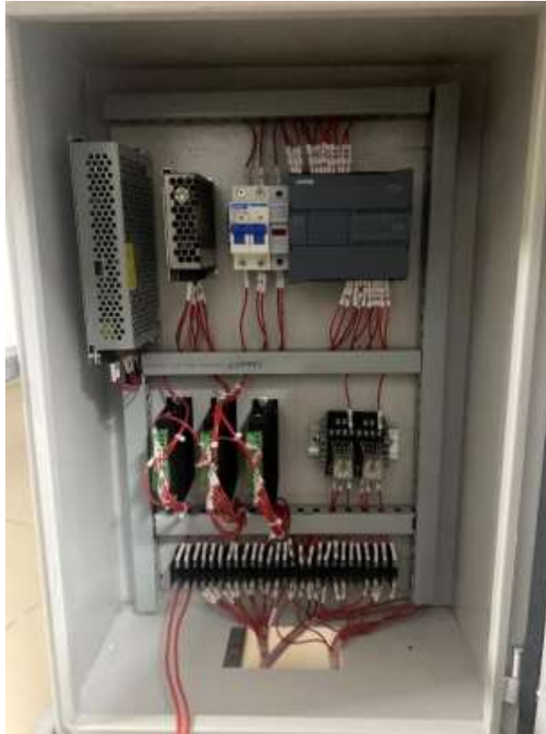
Hình 4.11 Tủ điện thực tế
