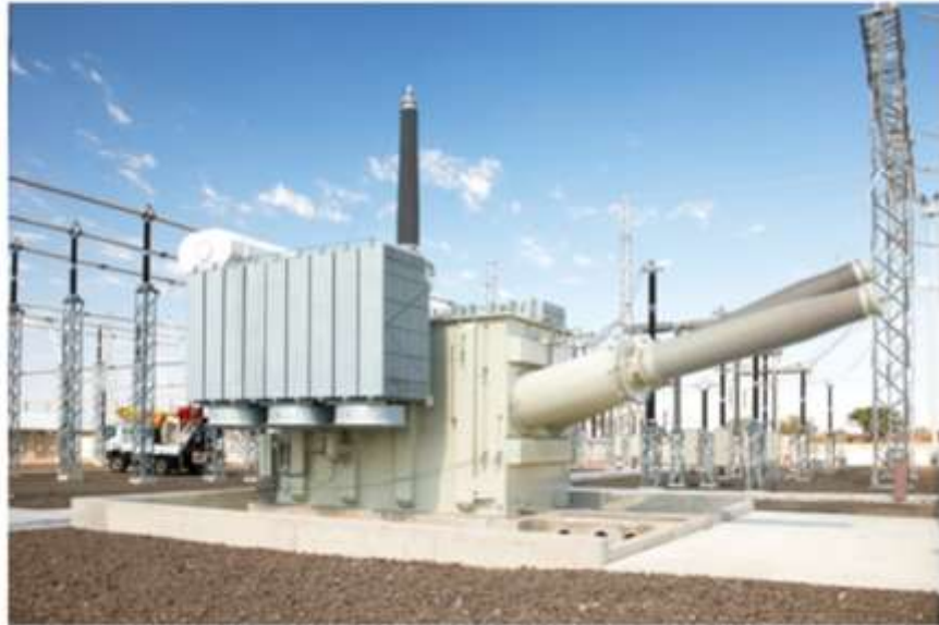
Hình 2. 14 Máy biến áp dự phòng tại trạm chuyển đổi VSC-HVDC Caprivi.
