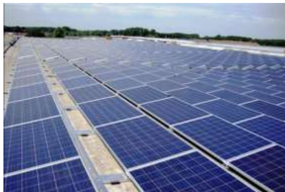
Hình 1.41 Hình ảnh Nhà máy Điện mặt trời Cát Hiệp
