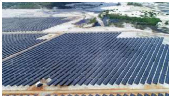
Hình 1.36 Hình ảnh Nhà máy Điện mặt trời Gio Thành 2
